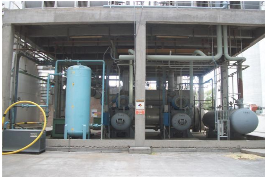
Figura 1.a. 3. Auxiliares: Compresores de amoniaco. (Bahia Blanca, 2012)
