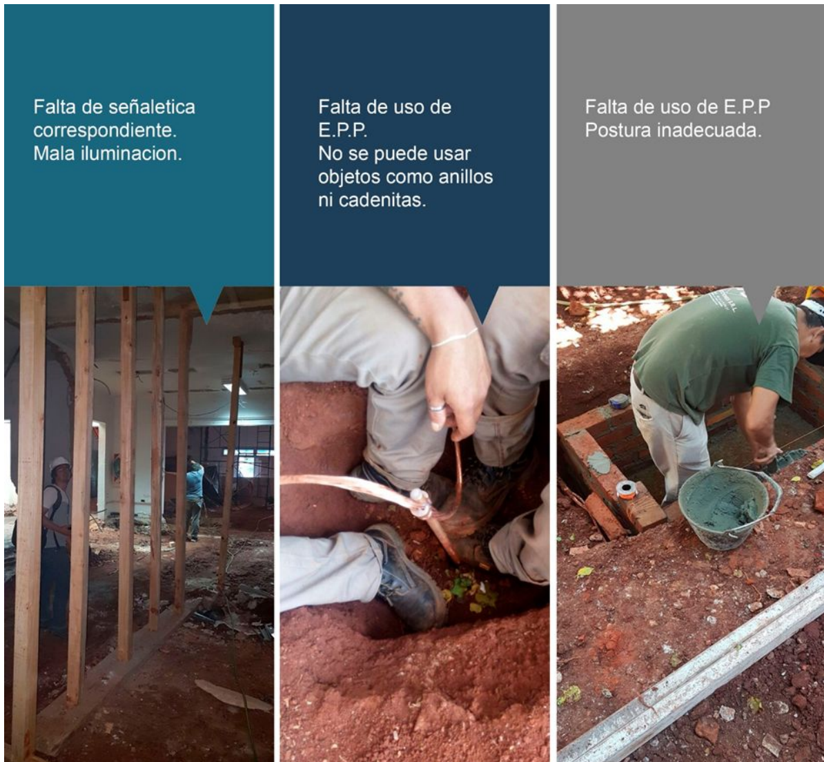
Figura N° 54 identificación de riesgos en la obra.
