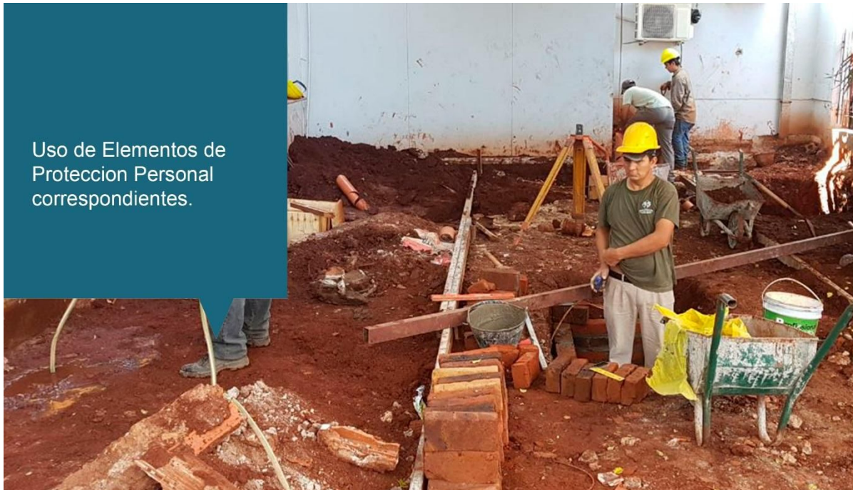
Figura N° 56 identificación de riesgos en la obra.
