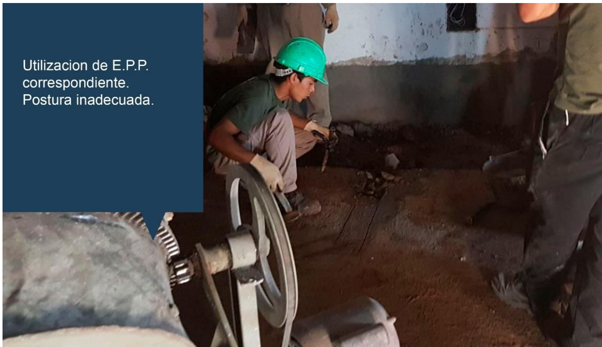
Figura N° 61 identificación de riesgos en la obra.
