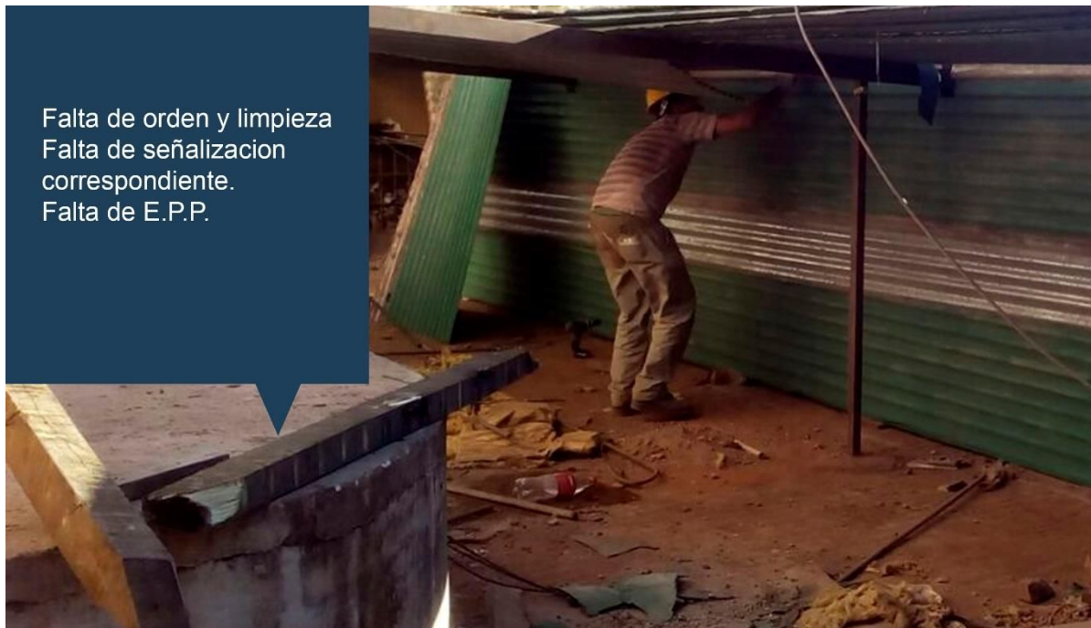
Figura N° 59 identificación de riesgos en la obra.
