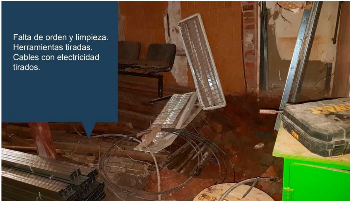
Figura N° 60 identificación de riesgos en la obra.
