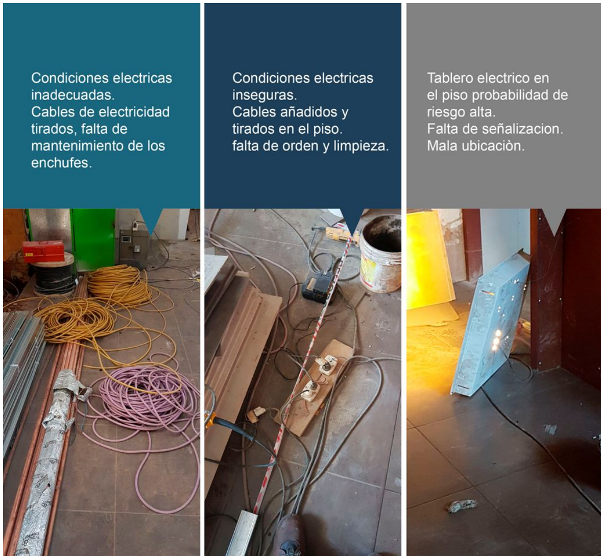
Figura N° 52 identificación de riesgos en la obra.
