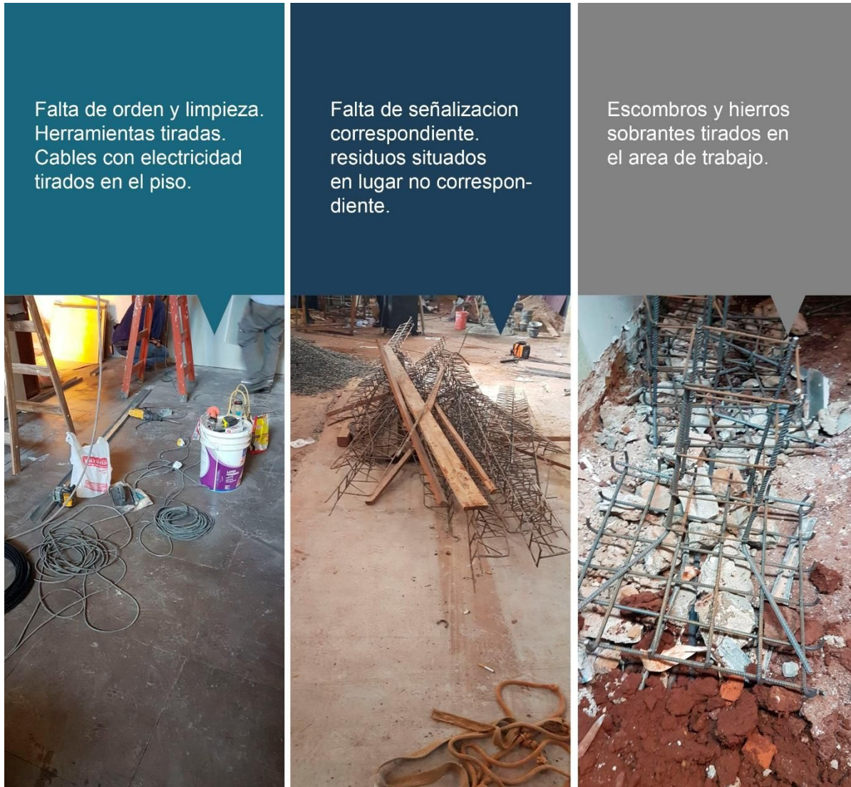
Figura N° 55 identificación de riesgos en la obra.
