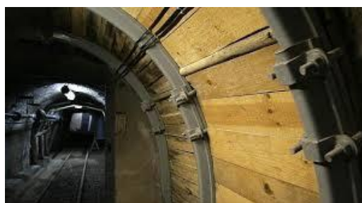
Sistema de sostenimiento de galerías con cerchas
